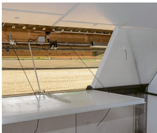
Die transparenten Schrägbretter dienen der Zuluftsteuerung und lassen Tageslicht in den Stall.
